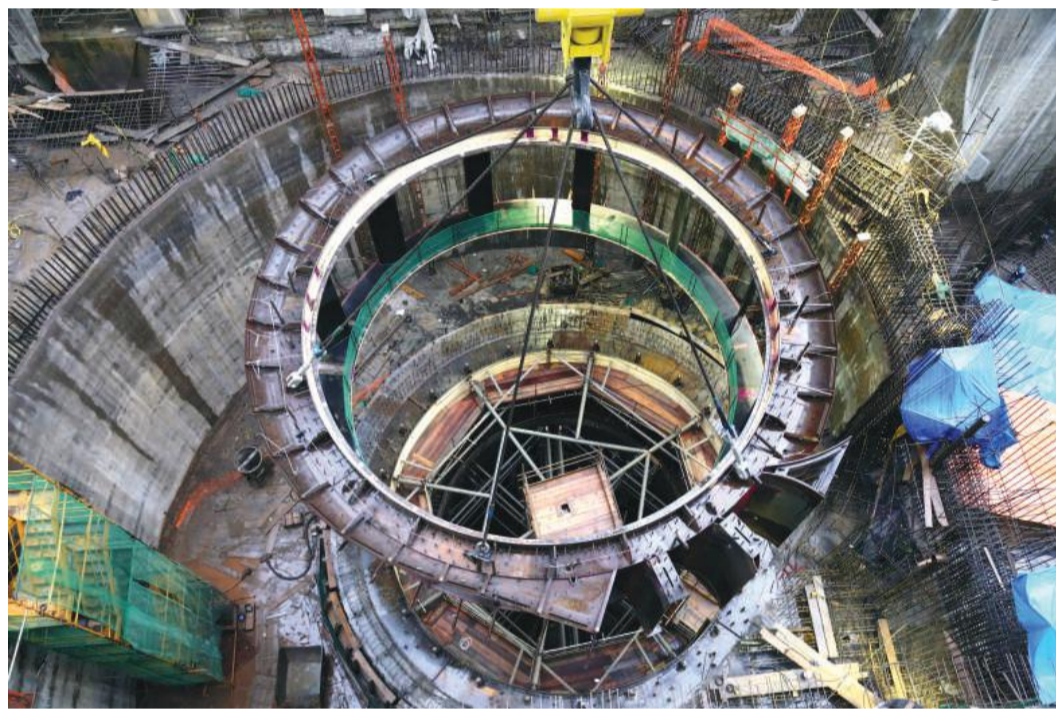
Usina estará em total operação até o fim deste mês com duas turbinas em atuação
