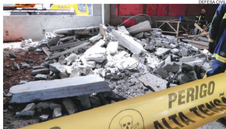
Desabamento aconteceu em prédio em obras
