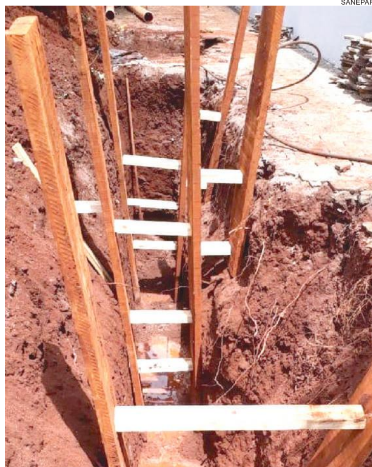
Cascavel tem hoje quase 1.000 km de tubulação que coleta o esgoto
