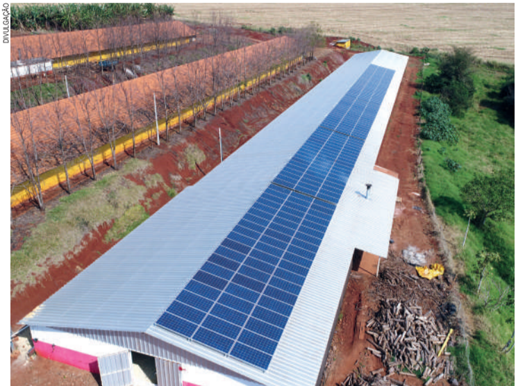
O sistema pode ser instalado em todos os segmentos e em imóveis de todos os portes
