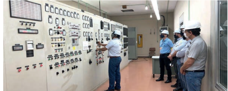
Sala dos Geradores Diesel: ensaio pressupõe que estão todos no escuro e a única fonte de energia para fazer o “start” da usina são os geradores diesel
