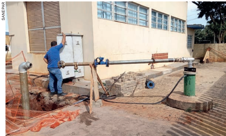
Novo poço aumenta a produção de água e contribui para suspensão do rodízio
