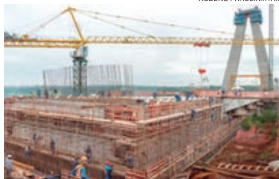
Entre as grandes obras de Itaipu, a Ponte da Integração, que chega a 52% de construção
