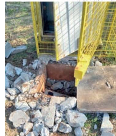
Instalações da Sanepar foram danificadas mais uma vez com o roubo de fios de cobre
