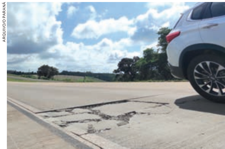
Em março, reportagem do O Paraná mostrou que ainda antes das obras serem concluídas, o novo pavimento de concreto já apresenta problemas
