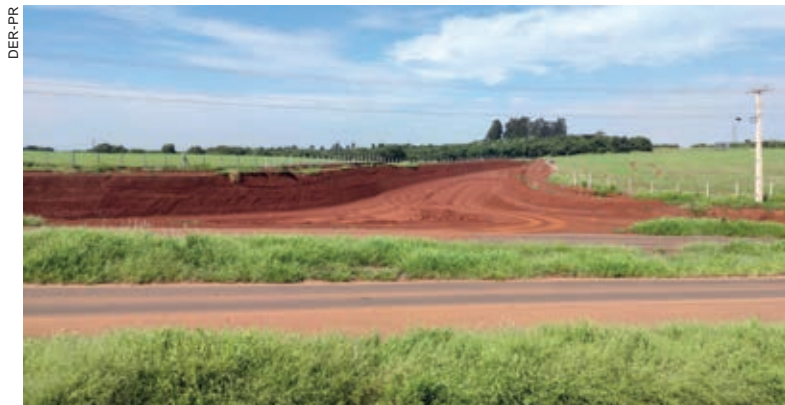
Chuvas de verão provocaram atrasos na evolução da obra que agora tem prazo até o final de agosto par ser concluída
