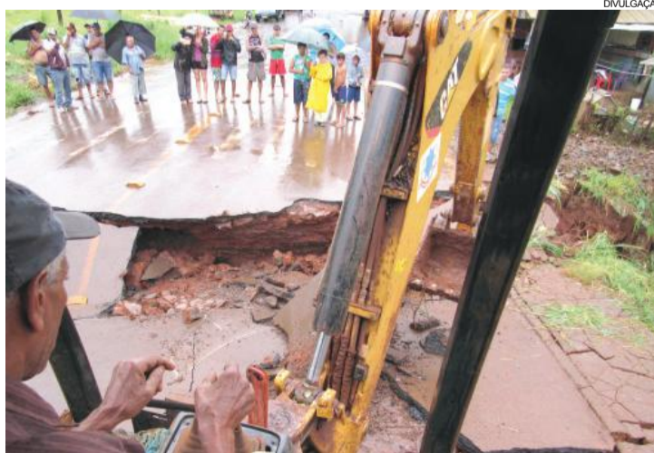
As equipes já estão trabalhando, mas a travessia está impedida
