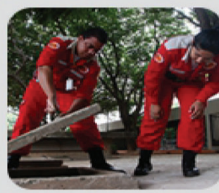
Caixas de passagem de água
