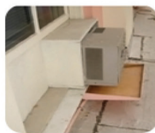
Bandejas de ar condicionado
