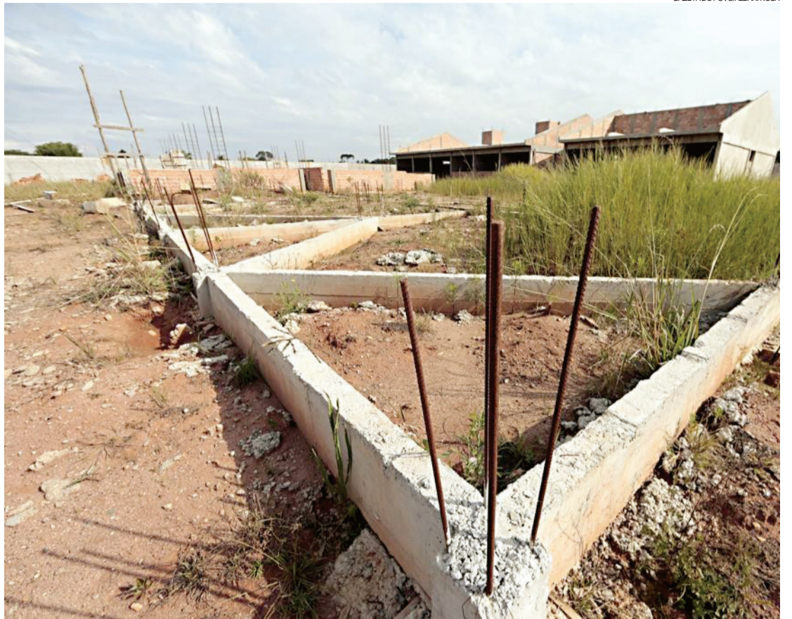
Obra de escola em Campina Grande do Sul, que era tocada pela construtora envolvida na Operação Quadro Negro
