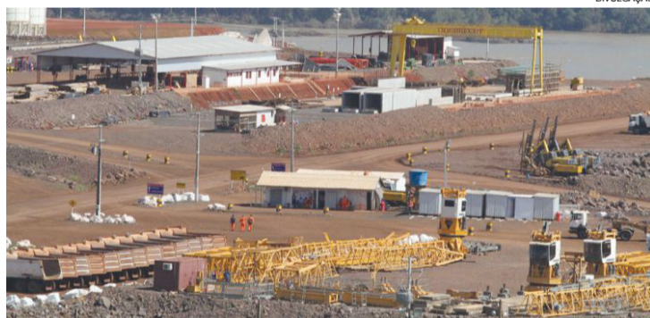
Usina está orçada em R$ 1,7 bilhão e está em obras entre Capanema e Capitão Leônidas Marques
