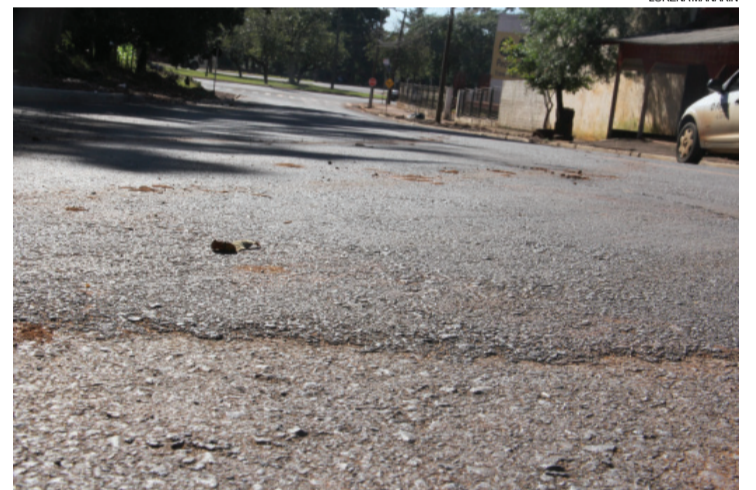
Remendo foi feito uma semana após a pavimentação
