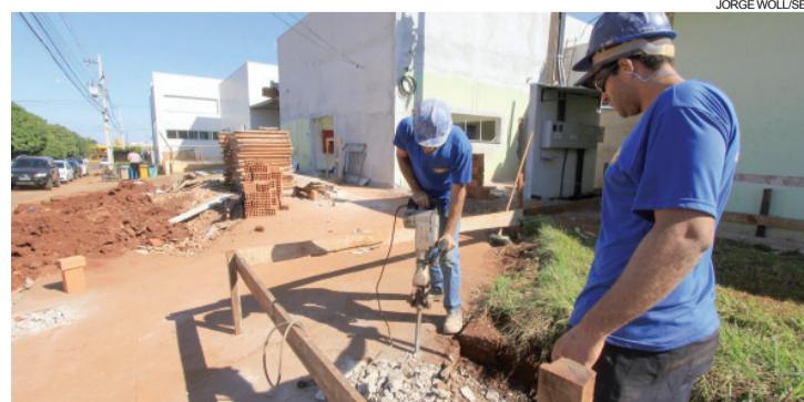
A obra compreende uma área total de 2.668 metros quadrados, sendo mais da metade destinada à ampliação da estrutura
