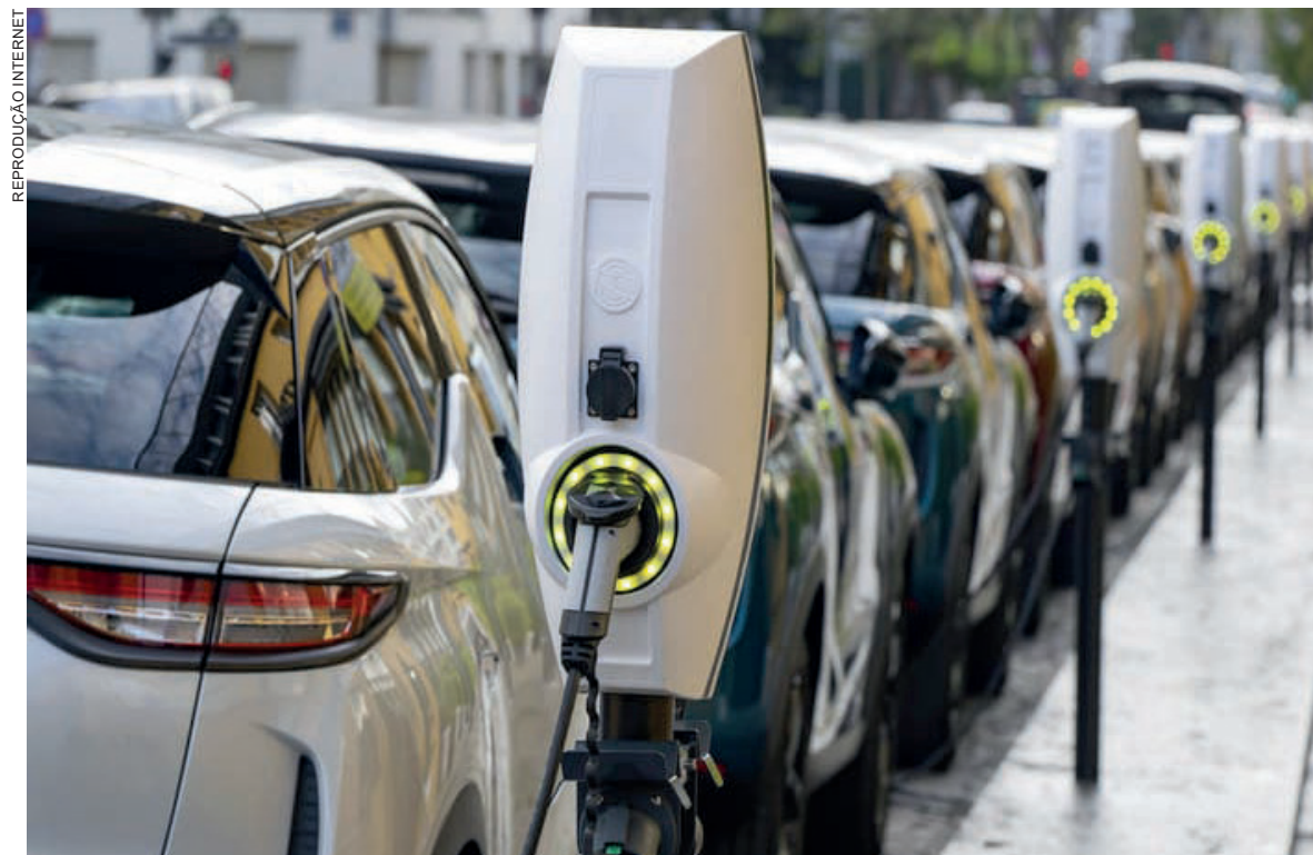
Os motoristas devem ter atenção redobrada com a instalação elétrica e qualidade dos equipamentos utilizados para recarregar seus veículos
