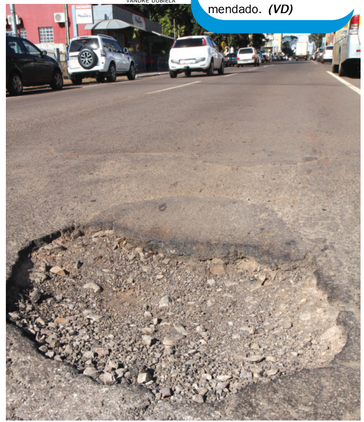
Os buracos e as crateras estão por todas as ruas asfaltadas da cidade
