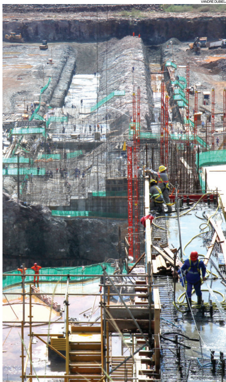
Usina Hidrelétrica de Baixo Iguaçu abastecerá um milhão de pessoas: obra deve ser entregue no segundo semestre de 2018
