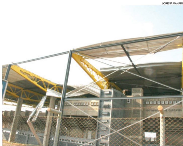
Cobertura do estádio foi transformada pelo temporal em metal retorcido
