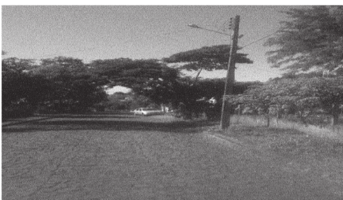
Figura 11: Árvore em conflito com a rede elétrica. Fonte: Elaborado pelo autor.
