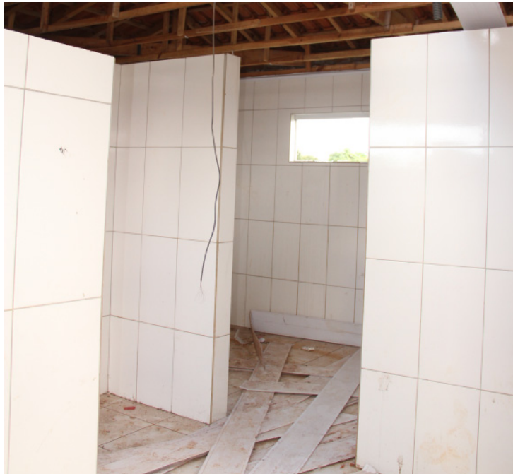
Banheiro em praça do Jardim Veneza está completamente destruído
