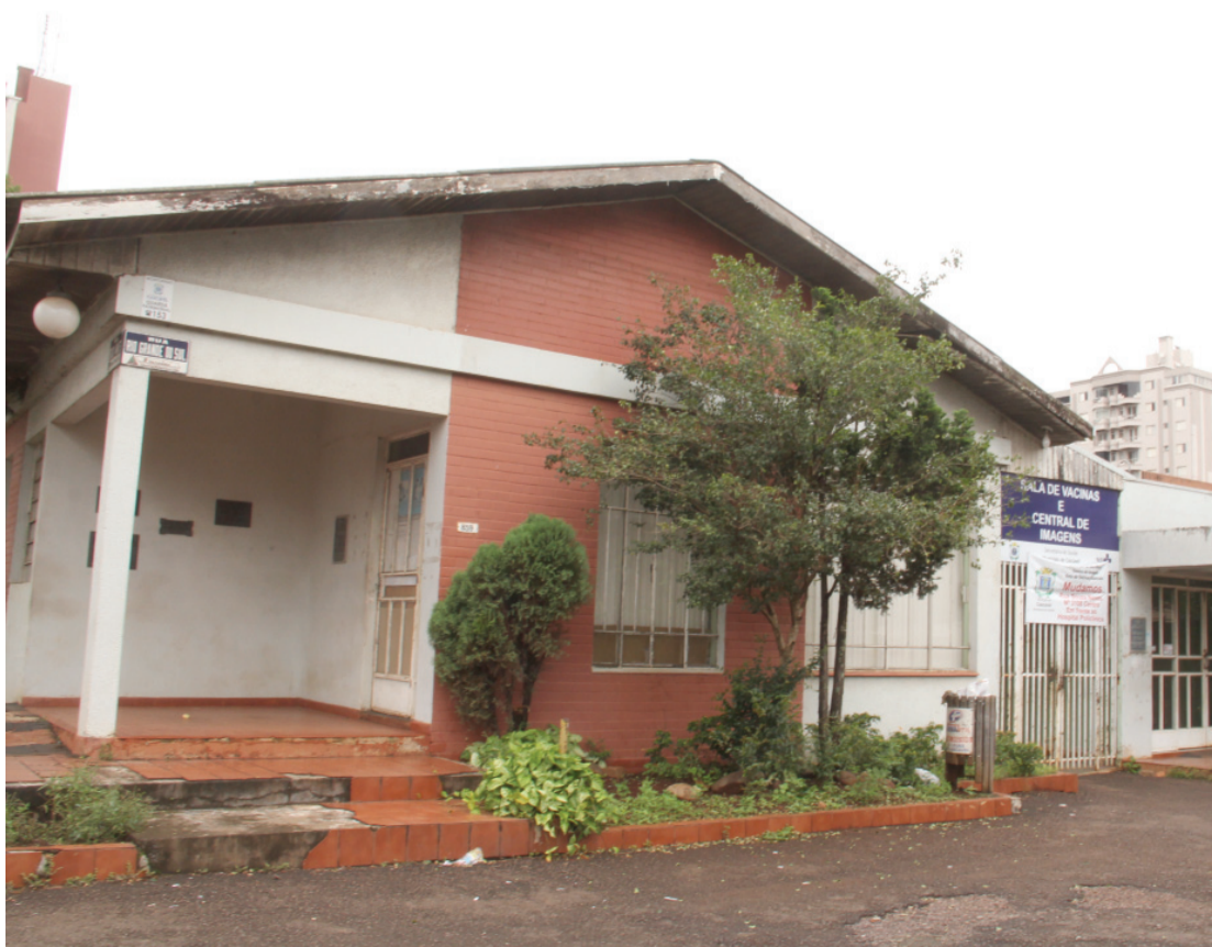
O prédio do antigo posto de saúde central encontra-se em situação precária
