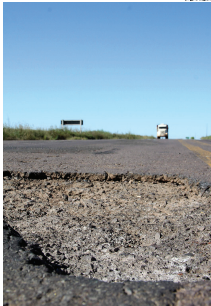
Situação da BR-163 é precária em trechos entre Cascavel e Capitão Leônidas Marques
