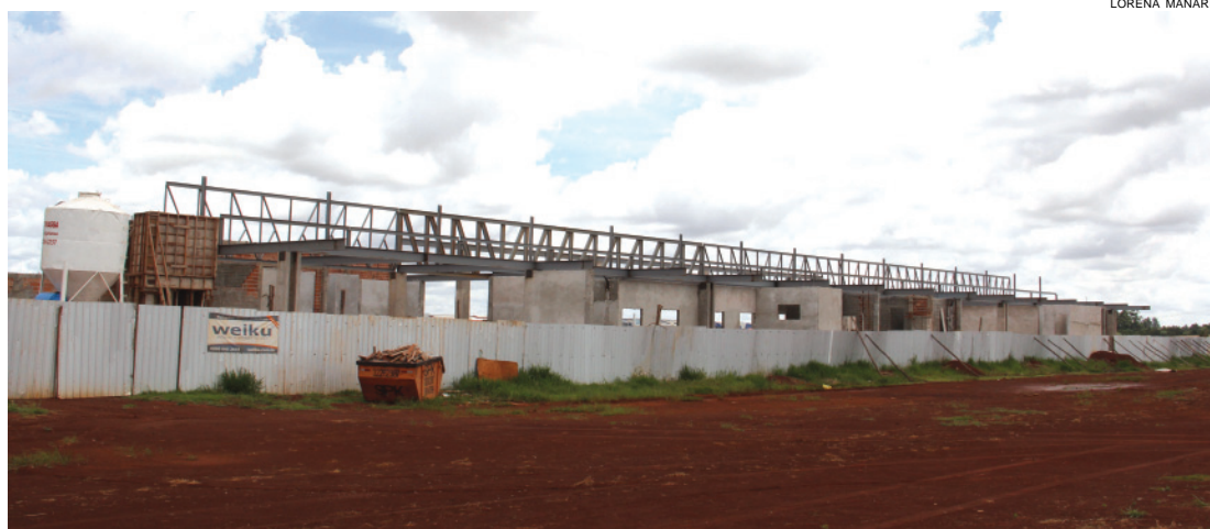
Obras do novo terminal de passageiros do aeroporto devem ser concluídas até julho deste ano
