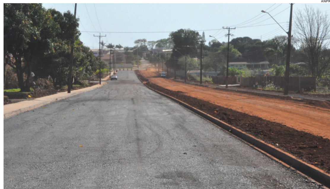
Obras vão contribuir para melhorar a qualidade de vida de três mil pessoas
