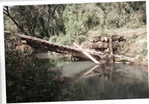
Ponte de acesso local dentro da Araúpel destruída.
