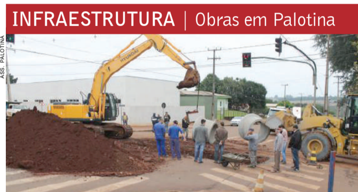
A administração pública de Palotina faz obras de ampliação da rede de galerias pluviais nas proximidades do Hospital Municipal. O trânsito é desviado com faixas informativas para veículos que trafegam na rota de caminhões, provisoriamente. Serão instalados 118 metros de rede, investimento de R$ 122 mil.
