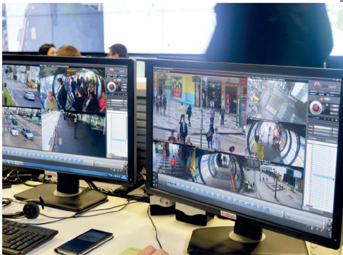
Estrutura permite videomonitoramento por meio da interligação com câmeras de
