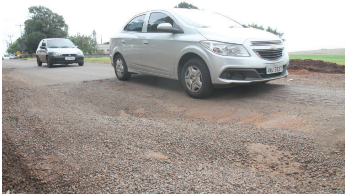
O trecho da PR-239 próximo a Nova Aurora precisa de recuperação imediata
