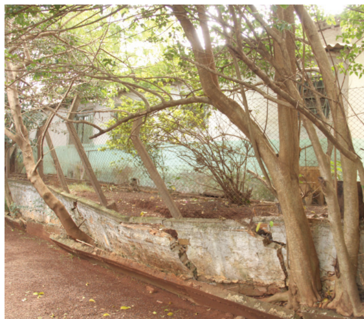
Muro entre salão comunitário e UBS ameaça cair. Moradores cobram melhorias da prefeitura
