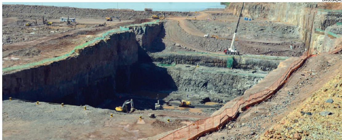
Obras foram iniciadas na metade de 2013: cheia do Iguaçu provocou sérios danos ao canteiro de obras
