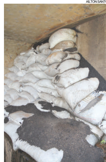
Em setembro, sacos com pavimento foram colocados debaixo da ponte
