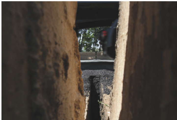
Estrutura apresenta fissuras que chegam a nove centímetros
