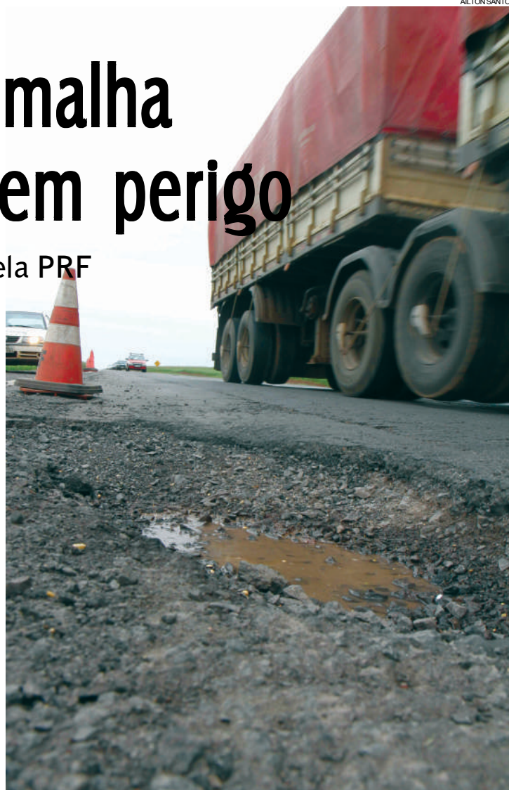
Um dos inúmeros buracos que tomam conta da rodovia 163
